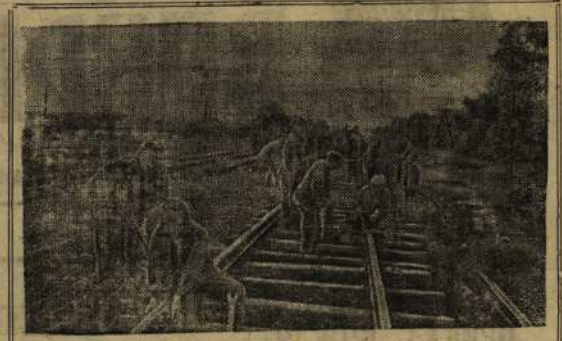
В освобожденном Донбассе сегодня. Ремонт ж. д. пути на одном из участков. Фото Д. Фавилевича.
