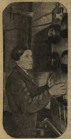
Н-ская электростанция. На снимке: дежурный инженер С. И. Семенова у щита управления.
